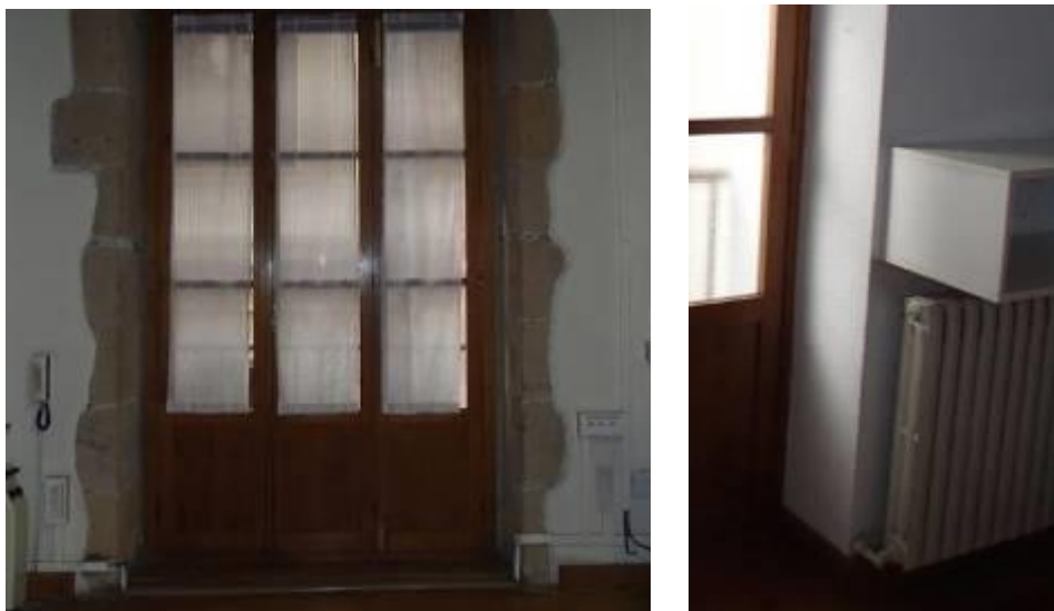
IMAGEN 4: ENCHUFES, CABLES Y RADIADORES DE CALEFACCIÓN EN PAREDES QUE SERÁN SUSTITUIDOS
