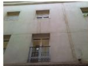
Fachada Norte San Pablo Detección de Puente térmico de estructura (1°C)
