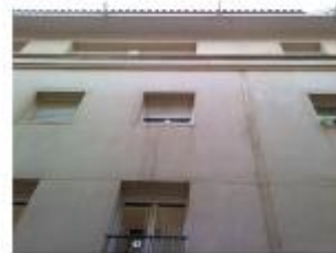
Fachada Norte San Pablo Detección de Puente térmico de estructura (1°C)
