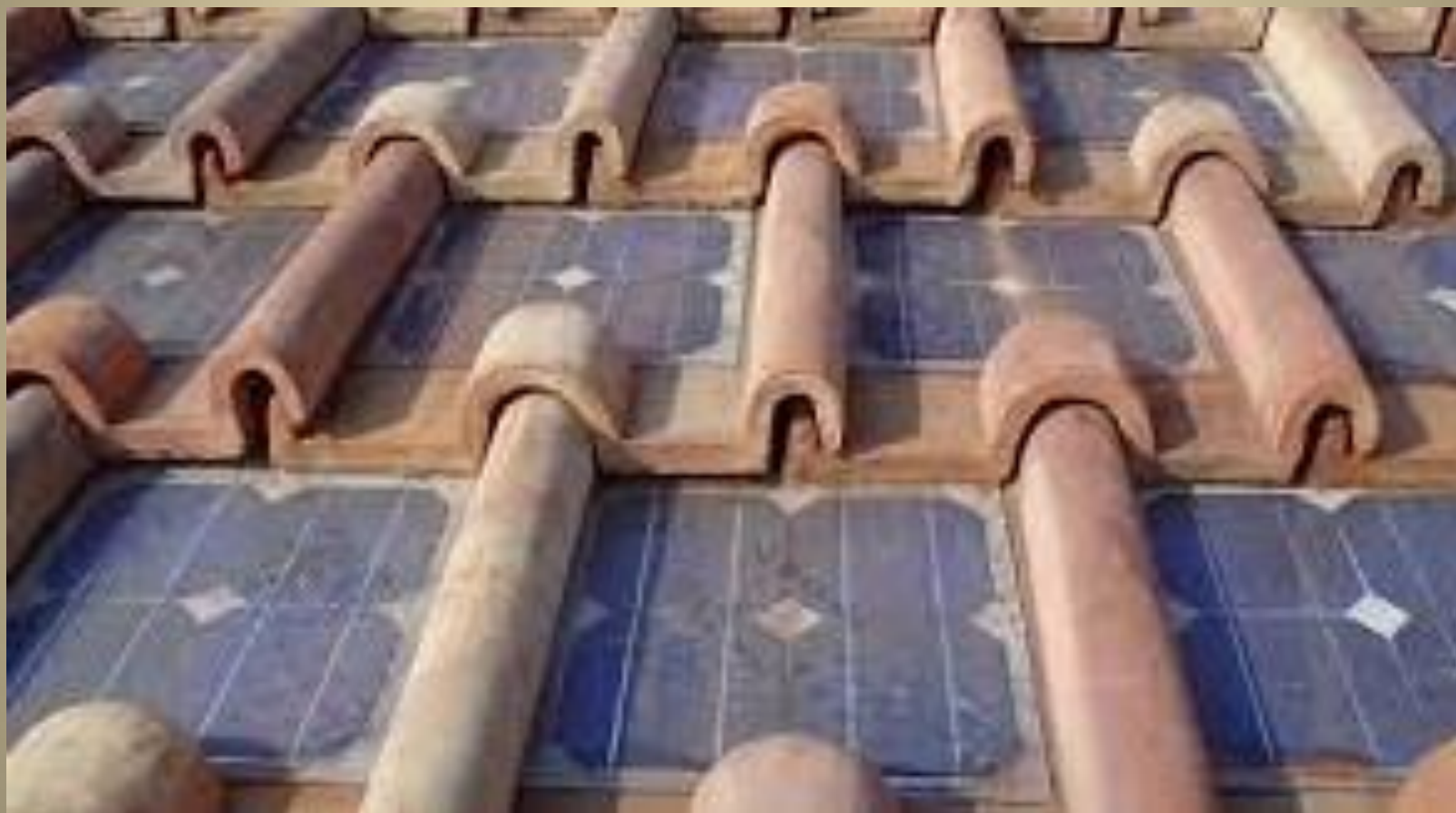
Sistema parzialmente integrato in copertura
