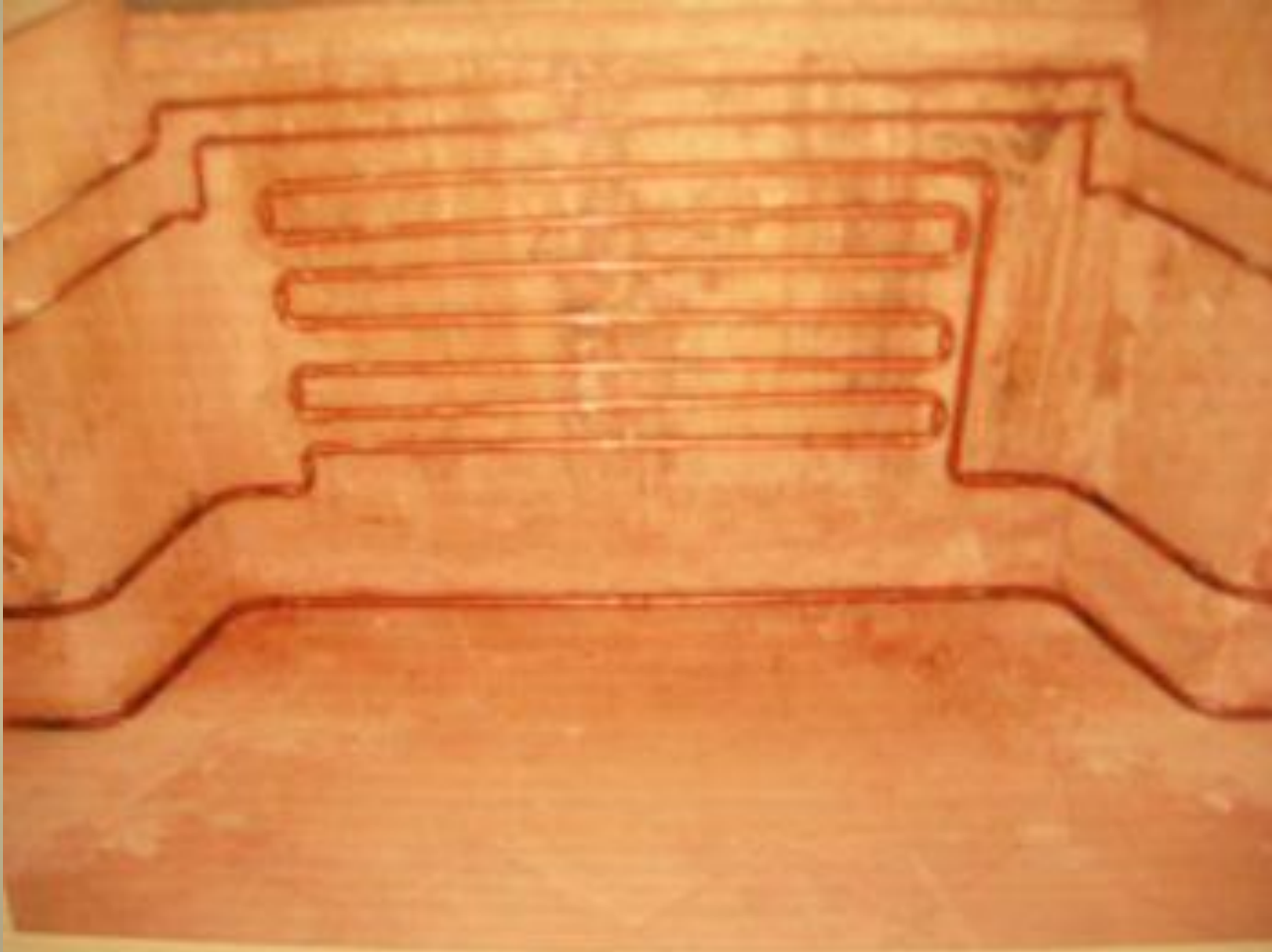
Sistema radiante interno
